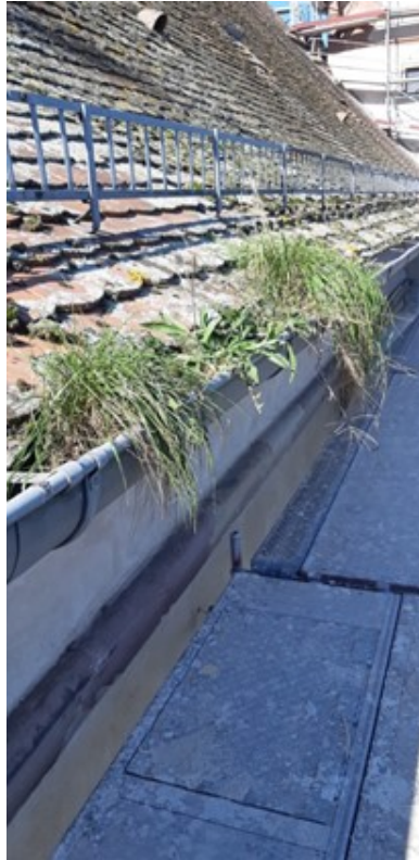
Herbes folles et gouttières bouchées...
